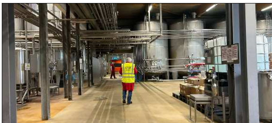
Abfüllanlage (links) und Tanks (rechts)
