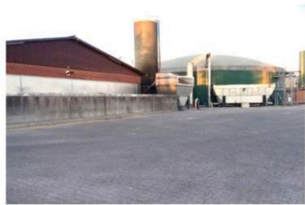
... ein Teil der Biogasanlage in Westerbakum !!
